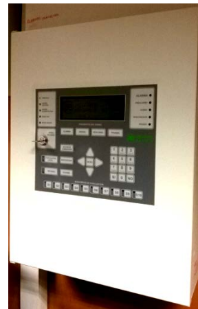
Central de alarma
